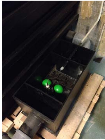
Photo 37: P-5 Oil filters in Västanfors station
