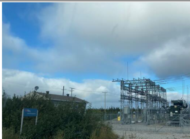
Photo 128 : Poste électrique d'Hydro-Québec
