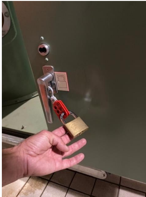
Photo 8 : Équipement avec verrou de sécurité personnel
