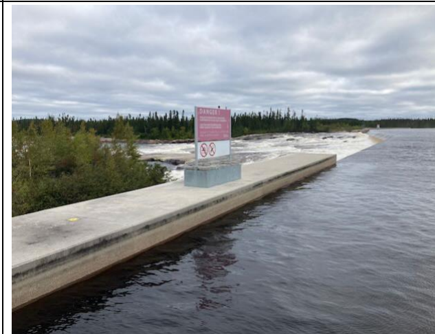
Photo 96 : Déversoir avec panneau d'avertissement pour les navigateurs
