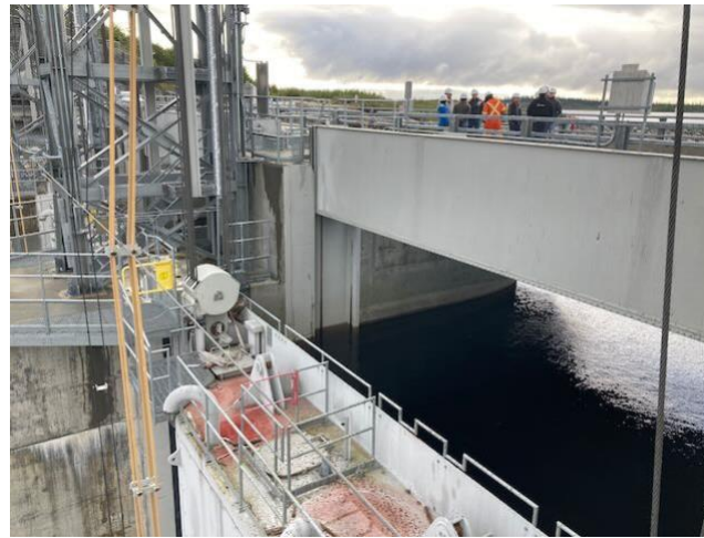
Photo 53 : Vannes de l'évacuateur du barrage Bernard-Landry
