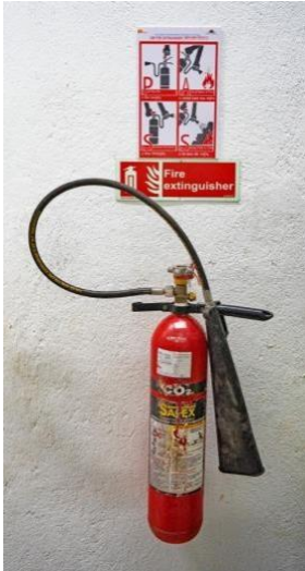
तस्विर१०: प्लान्ट वरपर प्रमुख स्थानहरूमा आगो निभाउने उपकरणहरू
