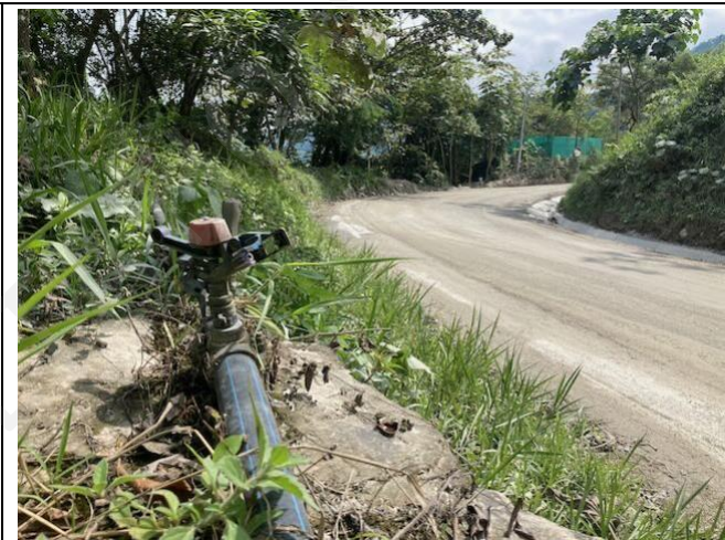
Foto 45: Sistema de rociadores para suprimir el polvo en las principales carreteras de construcción
