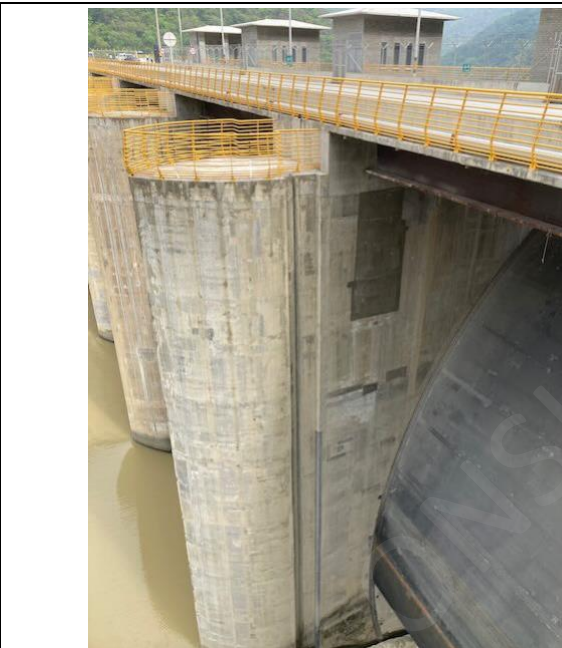
Foto 38: Compuertas de aliviadero
