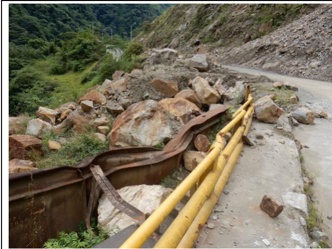
Foto 88: Daños por derrumbes de taludes en vía Puerto Valdivia
