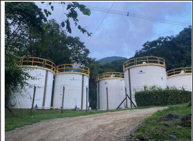
Foto 54: Almacenamiento de agua potable campamento EPM
