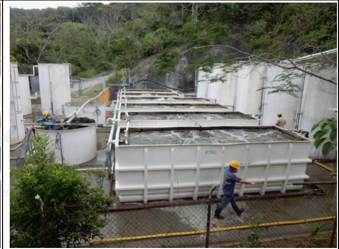
Foto 63: Planta de tratamiento de aguas residuales campamento CCC
