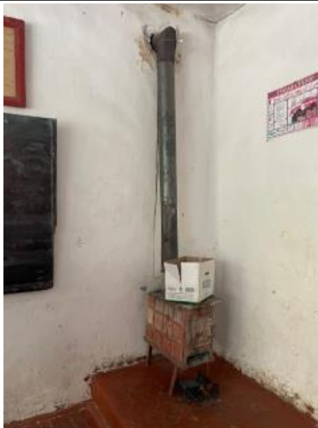
Фотография 113: Традиционная система отопления, используемая в существующем школьном классе
