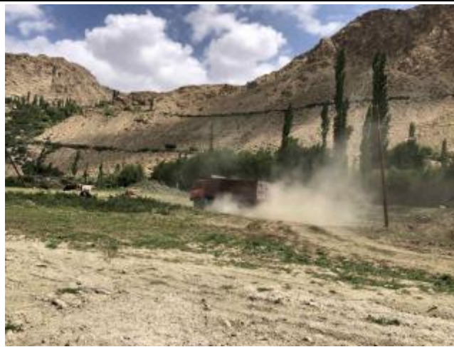
Фотография 35: Строительная дорожная пыль на водозаборе
